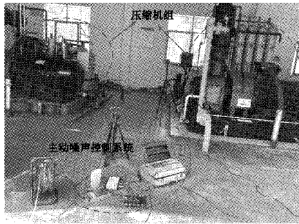
图 5 燃气站压缩机厂房内
